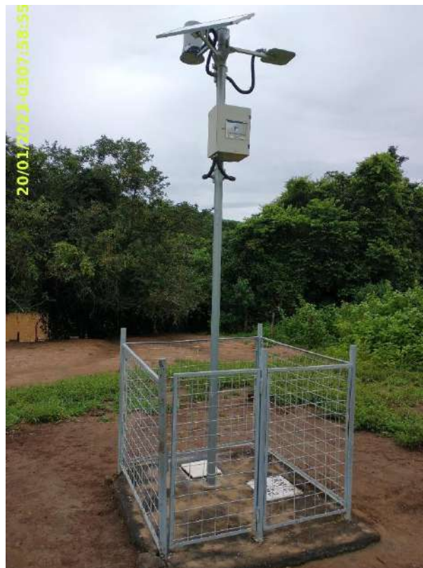
Estação Telemétrica Limpa (perto)
