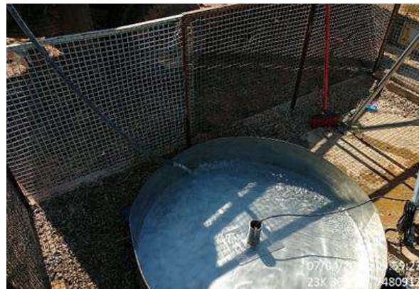
Foto 4 – Tanque do reservatório sendo preenchido com água. (Data: 07/04/2023).
