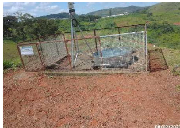
Foto 2 – Tanque do reservatório sendo preenchido com água. (Data: 08/02/2023).
