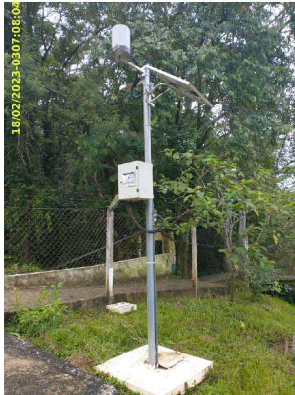
Estação Telemétrica Limpa (perto)
